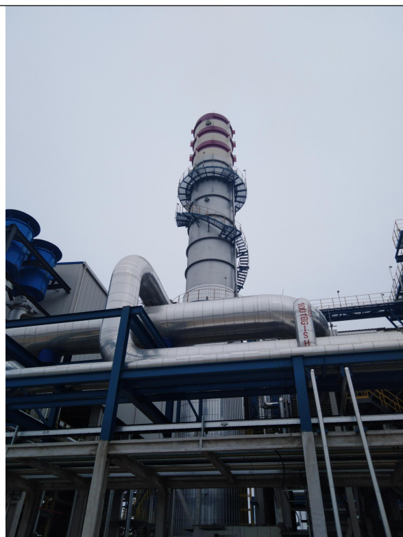
再生空气加热炉燃烧废气排气筒
